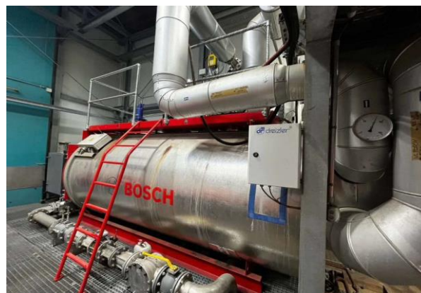
BOSCH製ボイラー
